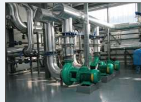
ОВК и водоснабжение
